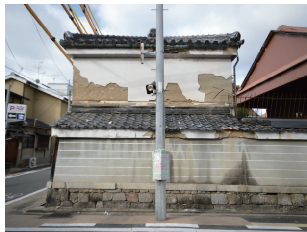
漆喰が剥がれて土壁が露出している
