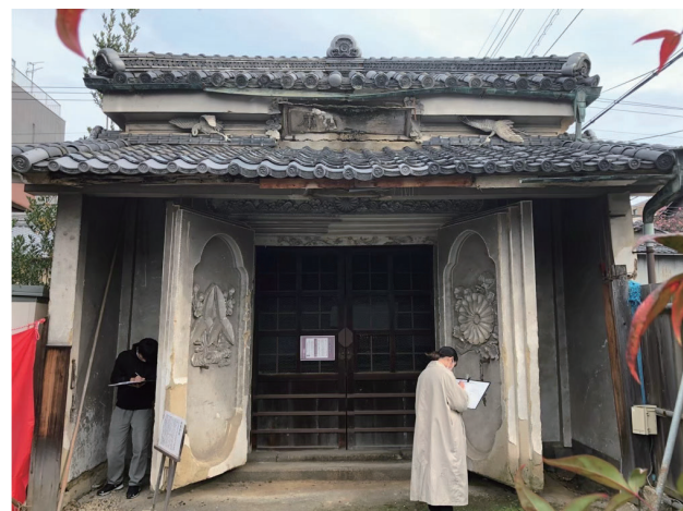
特に屋根や雨樋の損傷が目立つ
